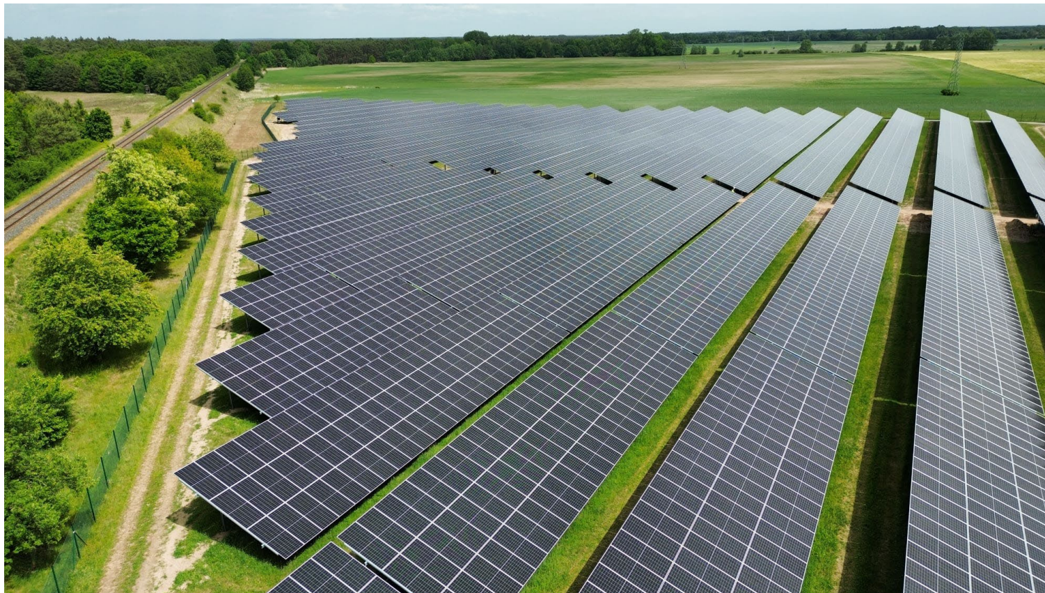
Solarpark Treuenbrietzen, Brandenburg, Deutschland
